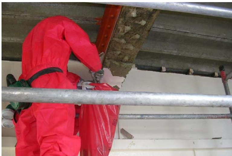
Figura 12.11 Ensacamento de resíduos junto ao ponto de remoção para prevenir a propagação e minimizar a exposição.
