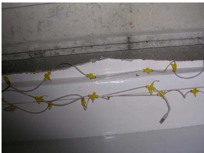
Figura 12.10 Exemplo de um sistema de injeção multi-pontos utilizado para humidificar isolamentos de amianto aplicado à pistola.
