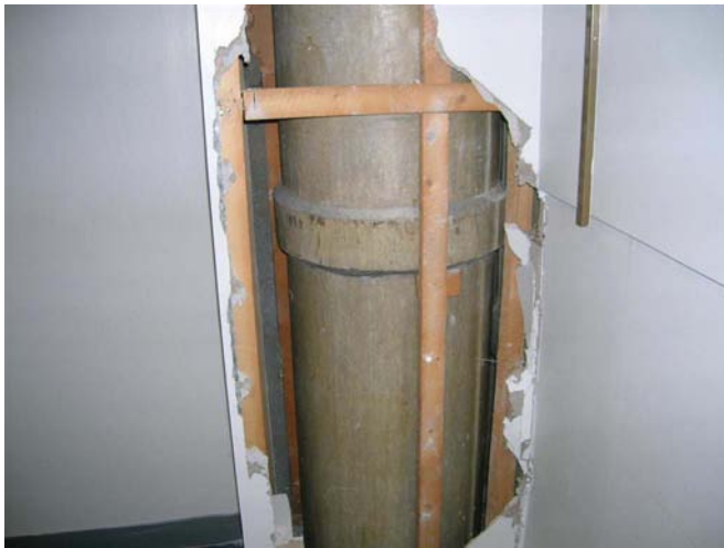
Figura 4.2 Caixa de painéis de isolamento de amianto, parcialmente removida, mostrando uma conduta de fibrocimento.
