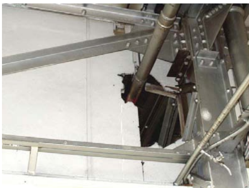
Figura 4.3 Divisória de painel de isolamento de amianto. Este exemplo ilustra as dificuldades que se colocam na prática para construir uma zona confinada adequada, bem como as superfícies em que as poeiras de amianto são susceptíveis de se acumular durante o processo de remoção.
