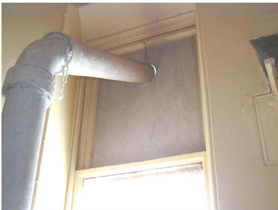
Figura 4.5 Conduto de fibrocimento com selantes de corda de amianto passando através de um painel sanduíche de amianto.
