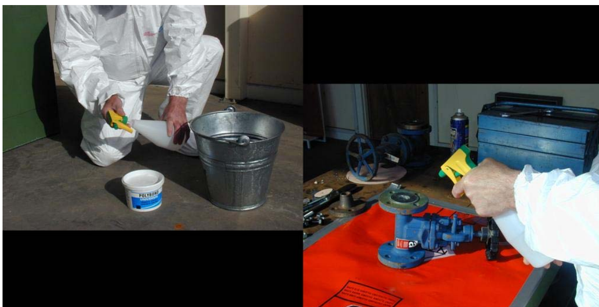
Figura 11.4 Humedecimento da junta de amianto de uma válvula.
