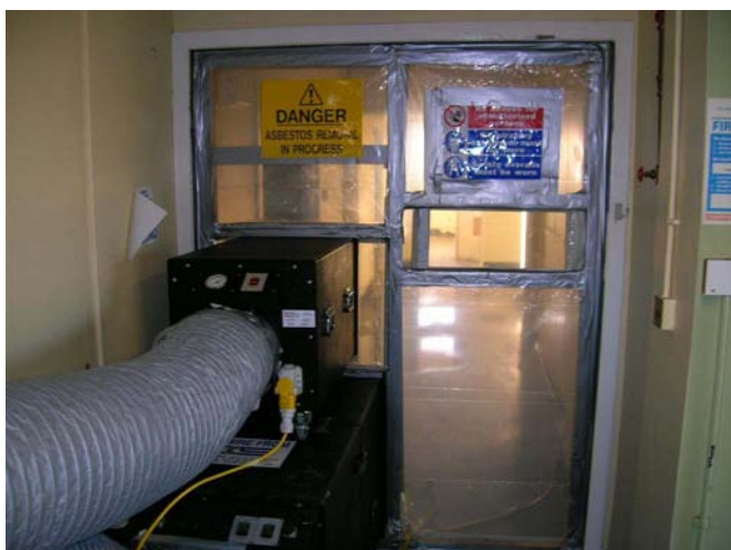
Figura 12.2 Unidades de pressão negativa e condutas de exaustão do ar, janelas e sinais de aviso.
