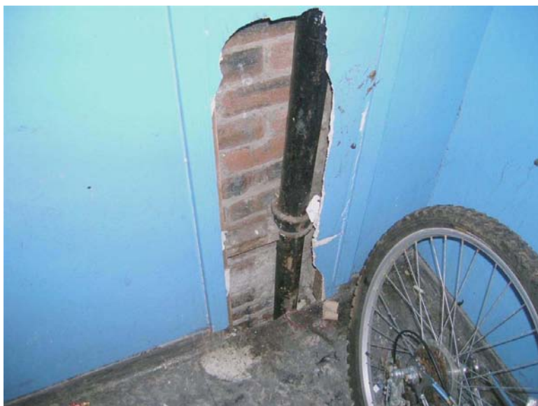
Figura 6.4 Painel de isolamento de amianto. Deve ser considerada a remoção uma vez que a localização do painel o torna vulnerável.
